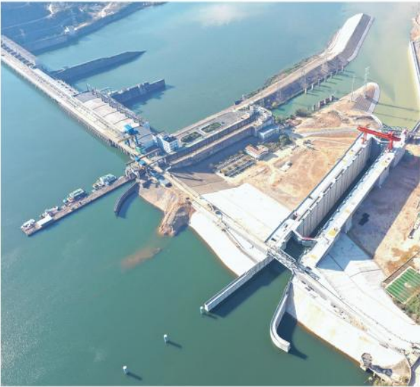
万安枢纽二线船闸主体土建 工程裂缝控制
