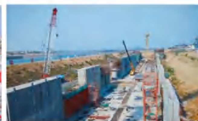
浙江衢州船闸大体量混凝土裂缝控制
