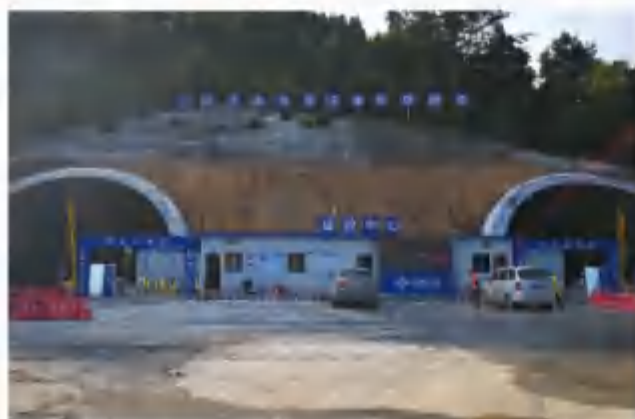
广东省广连高速公路元墩隧道监控量测、超前地质预报及高边坡监测
