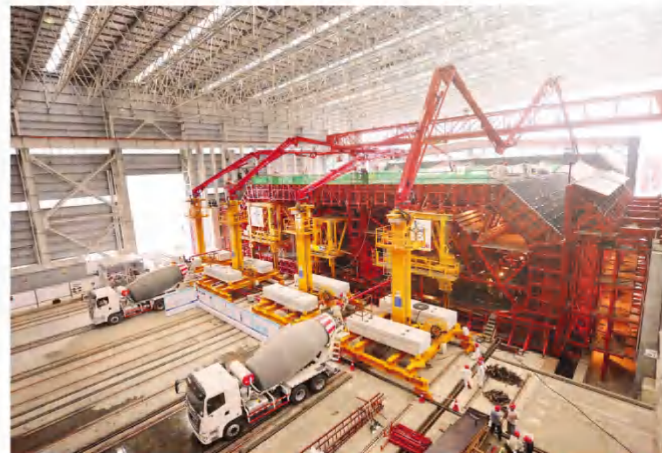
港珠澳大桥主体工程岛隧工程预制沉管管节裂缝控制
