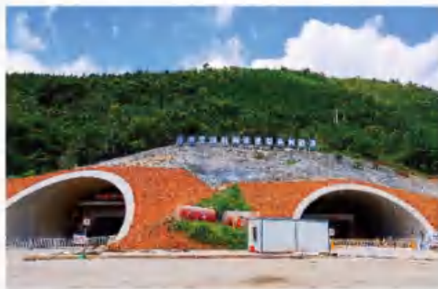
广东省开春高速公路犁头村隧道监控量测超前地质预报及高边坡监测
