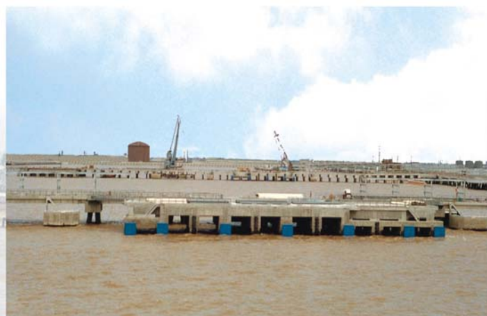
▲ 荣获“申港杯”的上海孚宝2.5万吨级液体化工码头及引桥工程
