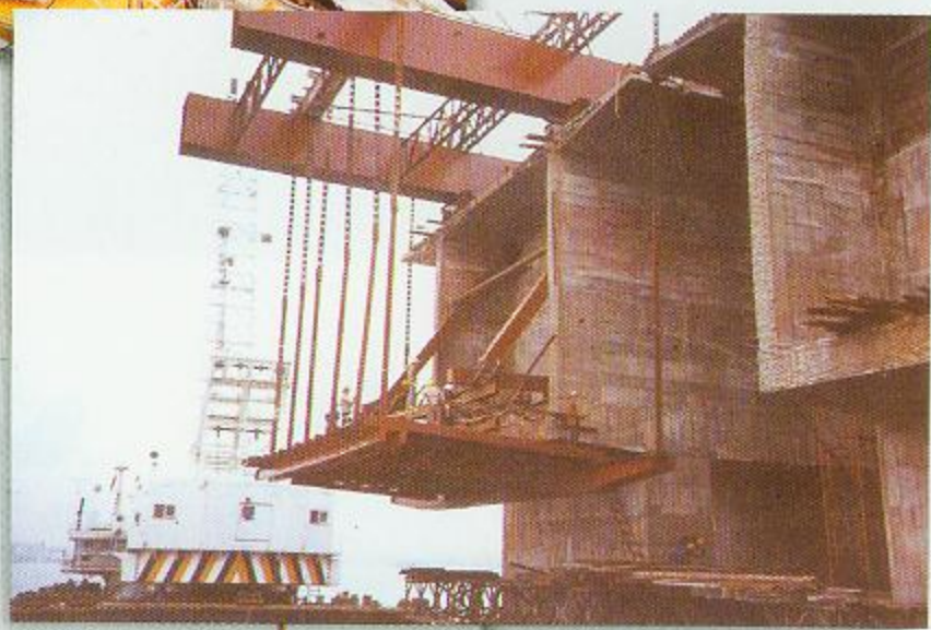
▶ 结构应力应变检测—广州华南 大桥施工挂篮模拟压载试验
